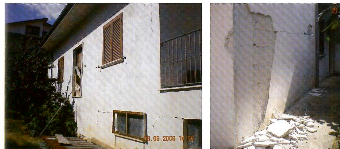
Figura 1 Rilievo preliminare: lesioni isolate in corrispondenza dell'unione tra struttura portante e tamponamenti esterni nel prospetto sud-ovest (a sinistra) ed espulsione di intonaci e parti nel prospetto nord-ovest (a destra).
