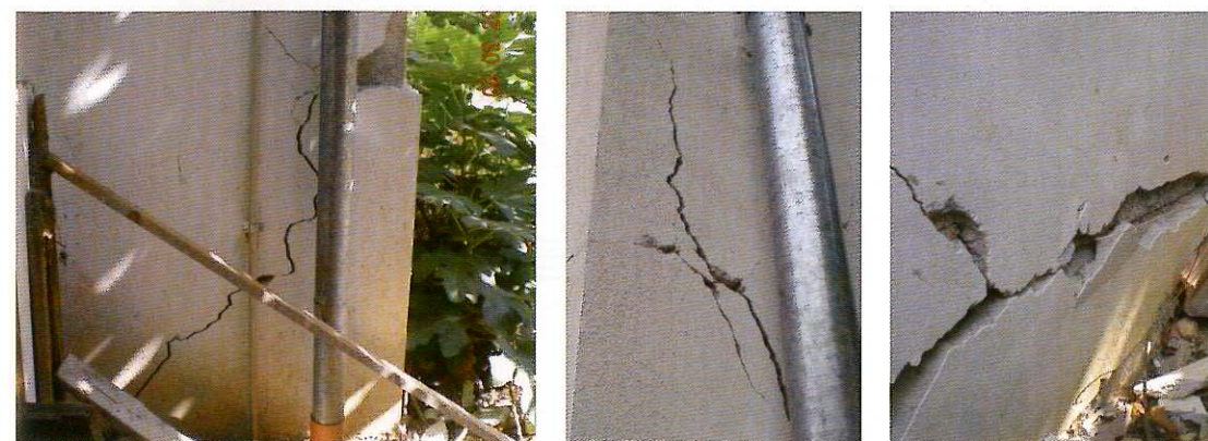
Figura 2 Rilievo preliminare: fratturazioni concentrate, decoesioni localizzate con espulsione di intonaci e parti e corrugamento intonaci in corrispondenza del prospetto nord-ovest.
