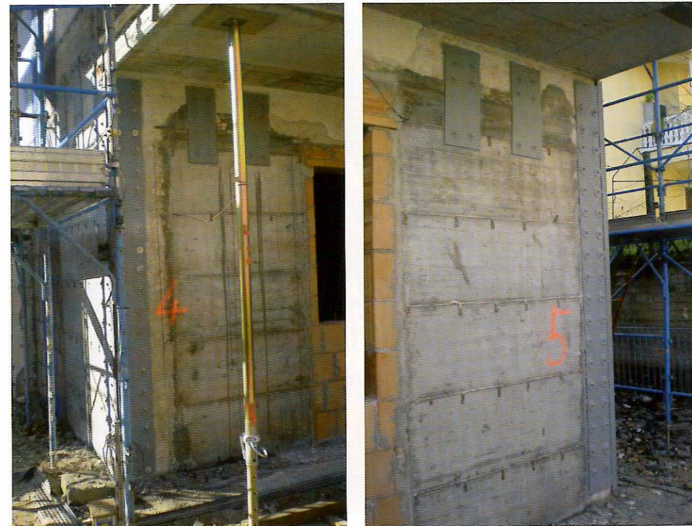
Figura 9 Rinforzo delle travi di fondazione. Dettaglio dei fori per il tassellamento dell'armatura di collegamento (in alto a sinistra), dettagli delle gabbie di armatura prima del getto (in alto a destra, al centro ed in basso).
