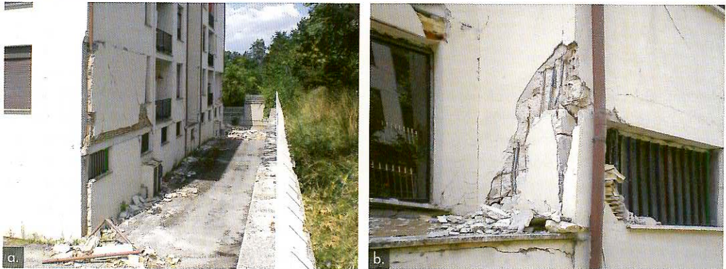
Figura 6 Rilievo di alcune lesioni esterne degli edifici 2 e 3 (Figura 2): a) e via Francia 28 b) del lato nord ovest.
