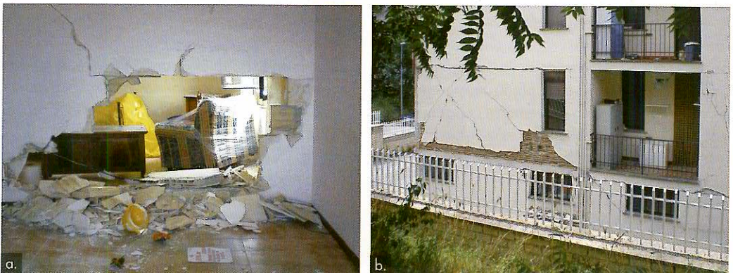
Figura 7 Rilievo di alcune lesioni degli edifici 2 e 3 (Figura 2): danneggiamento dei tamponamenti interni a) ed esterni b).
