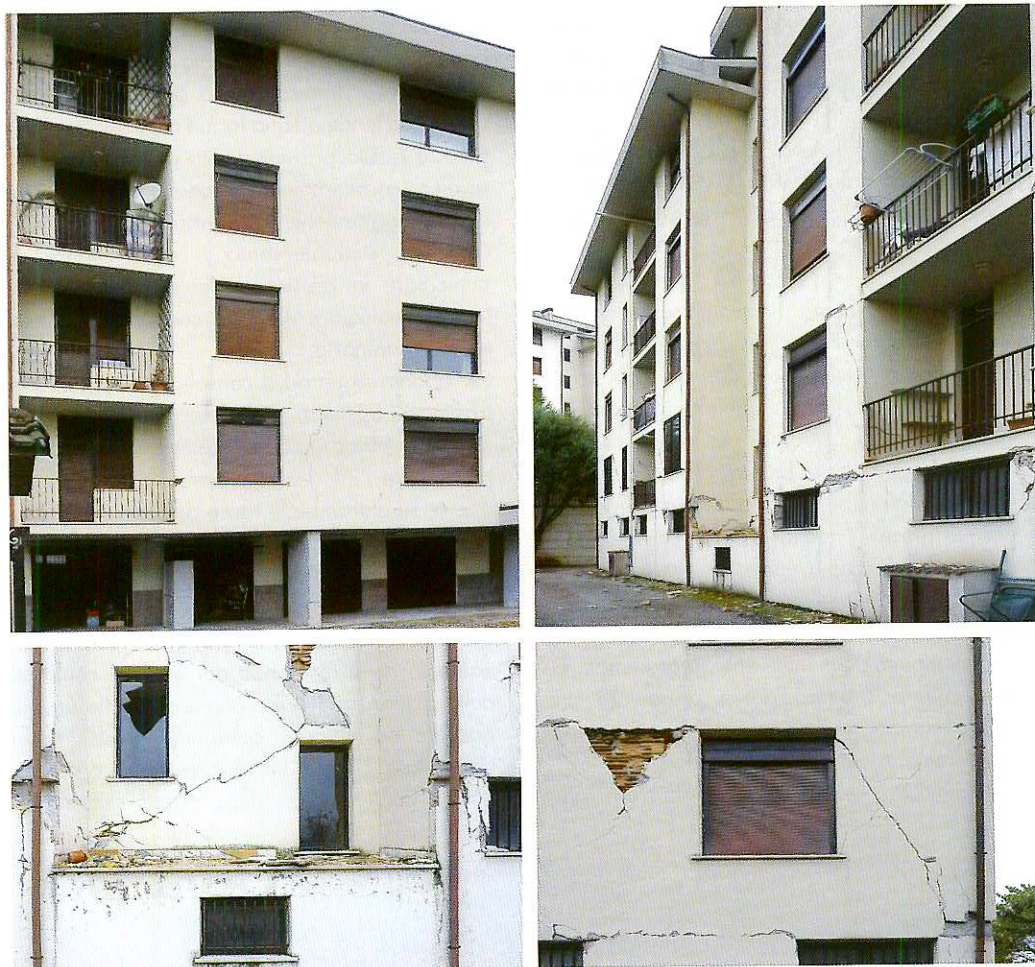
Figura 8 Rilievo di alcune lesioni esterne dell'edificio 1 (Figura 2): danno rilevato meno esteso e di grado inferiore rispetto agli edifici 2 e 3.
