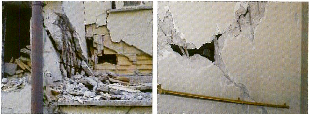
Figura 5 Rilievo di alcune lesioni esterne dell'edificio 2 (Figura 2): particolarmente concentrate nella zona del vano scala a piano terra.
