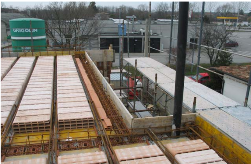
Figura 6- rientranza edificio priva di ponteggio
