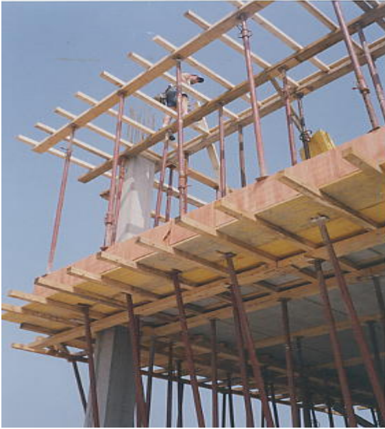
Fig. 4 Assenza di protezioni contro la caduta
