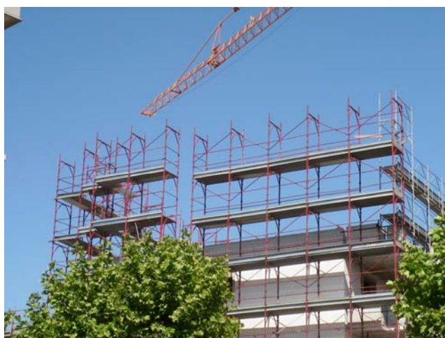
Figura 13– Ponteggio privo di ancoraggio
